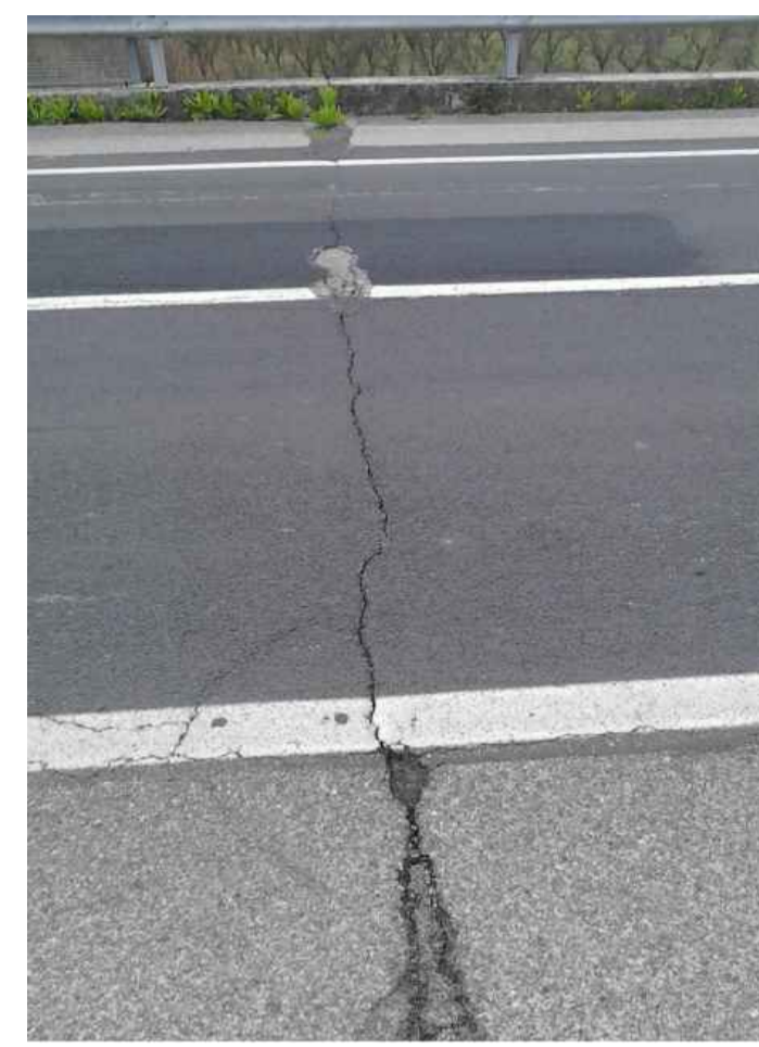
PONTE SP 33 PK 0+530 : GIUNTI DA RIPRISTINARE
