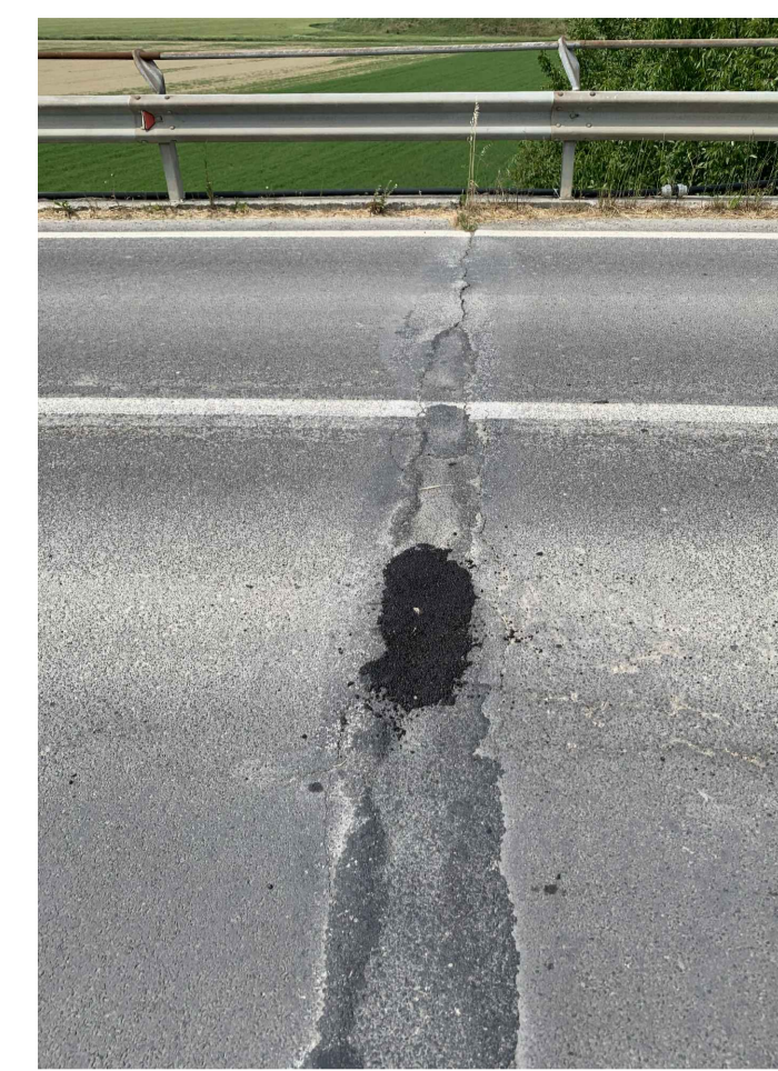
PONTE SP 101 PK 4+866 : GIUNTI DA RIPRISTINARE
