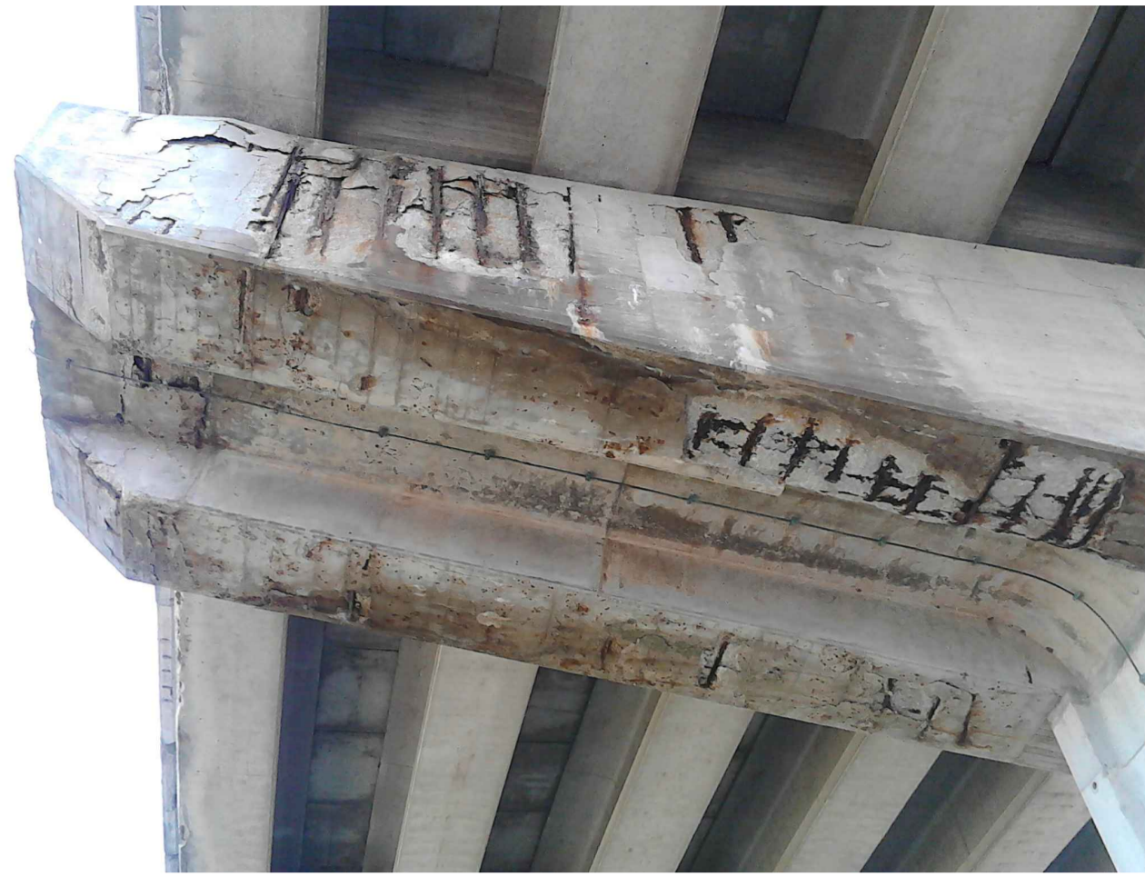
PONTE SP 99 PK 5+576 : PULVINO E PILA SUD DA RIPRISTINARE
