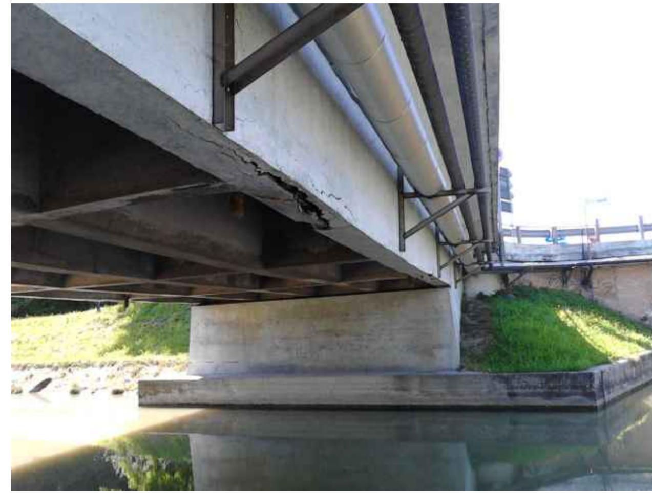
PONTE SP 1 PK 3+575 : TRAVI DI BORDO DA RIPRISTINARE
