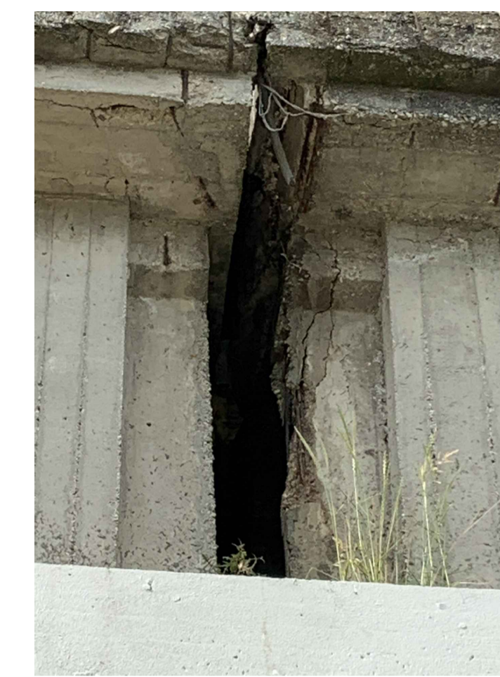
PONTE SP 101 PK 4+866 : GIUNTI DA RIPRISTINARE VISTA DAL BASSO
